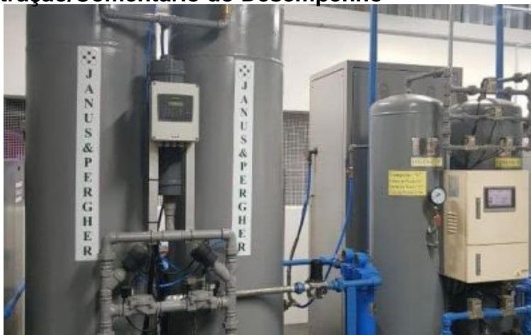
Gerador de nitrogênio, gerador de oxigênio e Sistema de purificação de biogás CETRIC – SC
