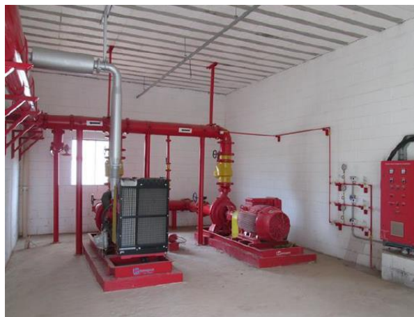
Casa de Bombas
