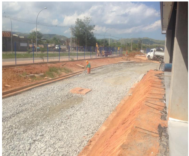
Acerto de Base e Corte de Talude em Rua Interna Paralela a Estrada dos Guaranis.
