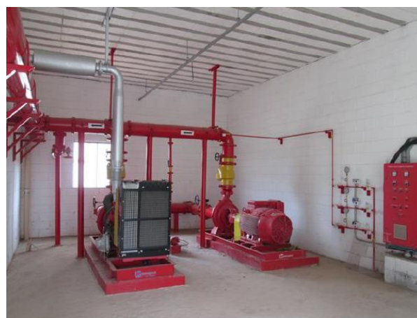
Casa de Bombas
