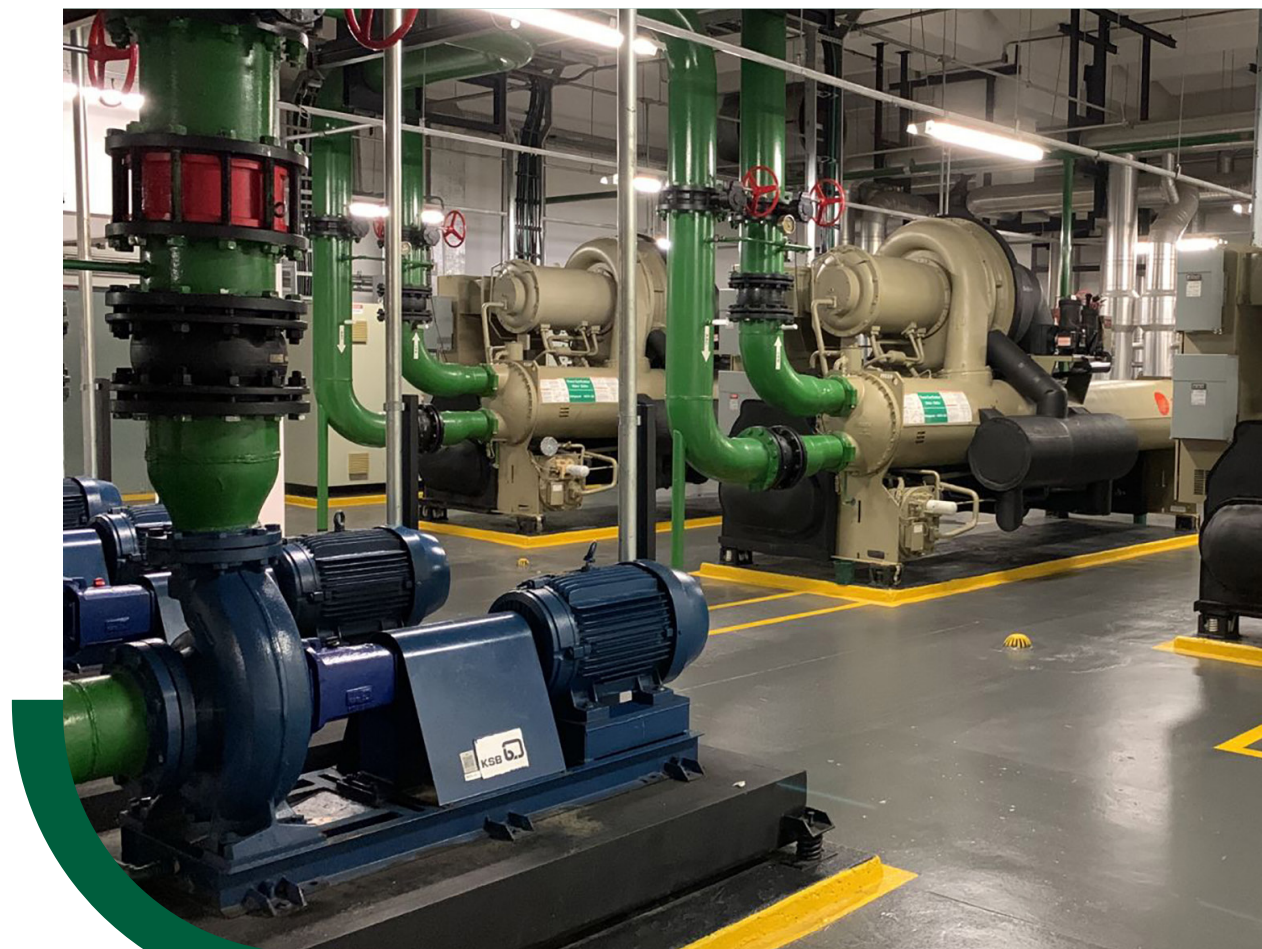
Central de Água Gelada, VillageMall, RJ.
