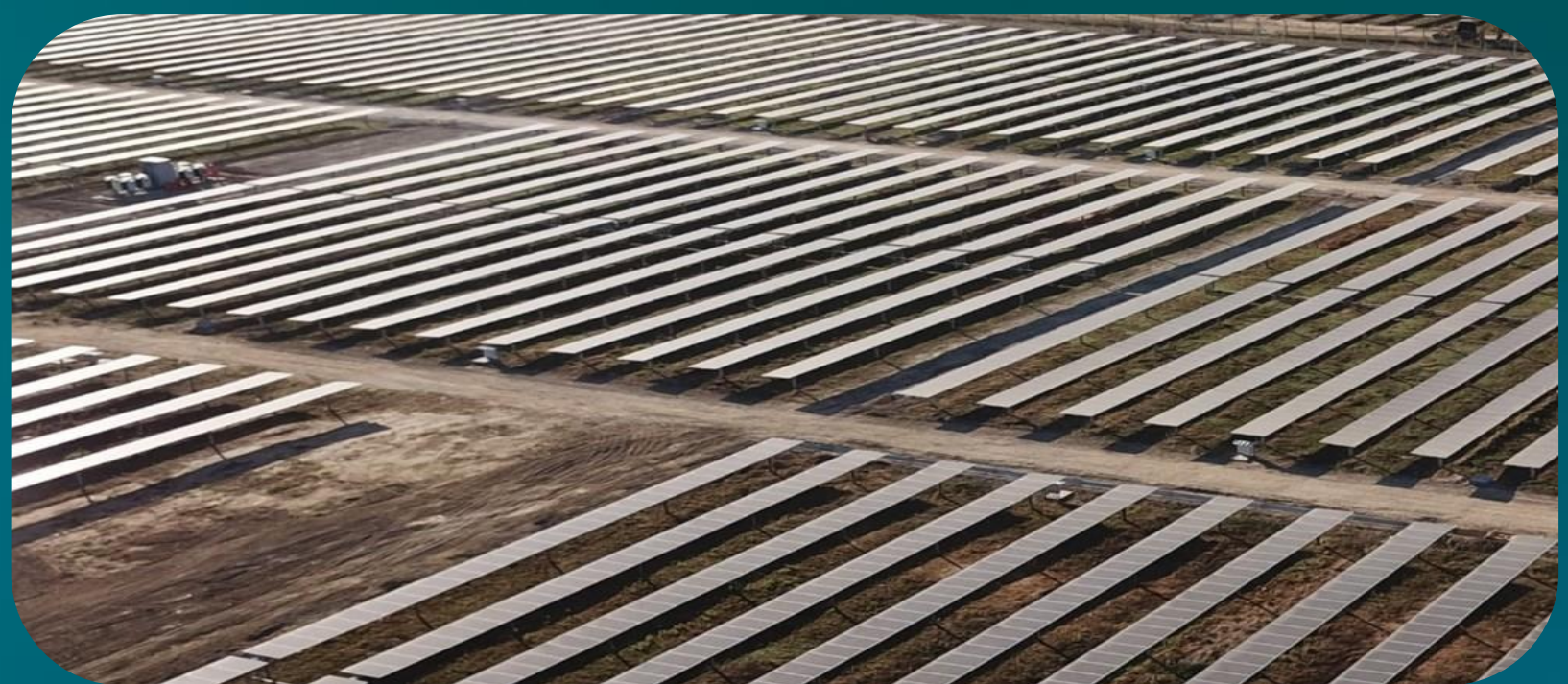
Usina fotovoltaica em Minas Gerais
