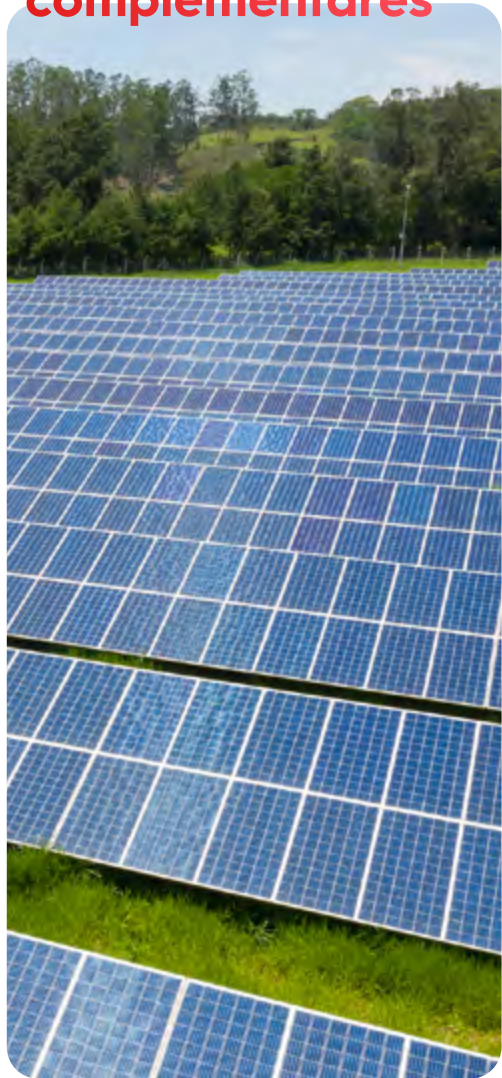
Painéis de energia em Fazenda Solar.
