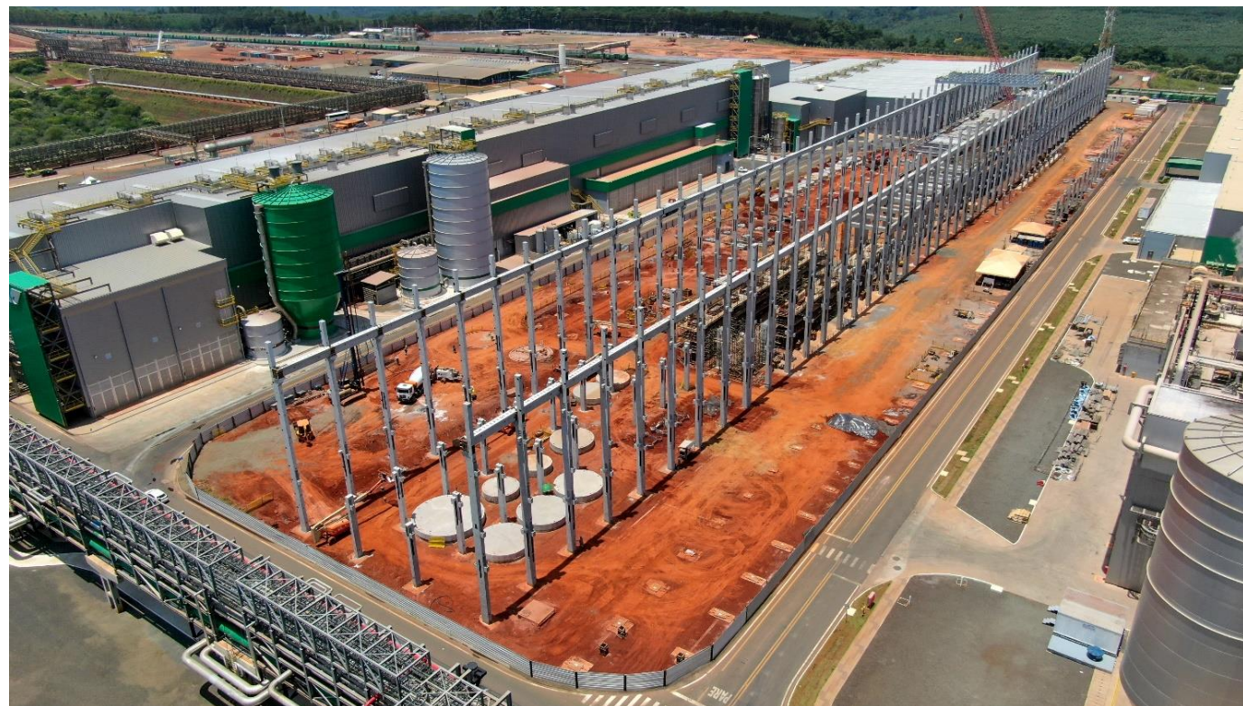
Imagem da obra da 2ª Máquina de Papel (MP28) do Projeto Puma II em Ortigueira-PR em 26/01/2022
