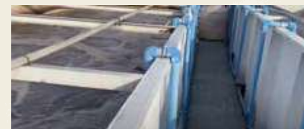
Estação de Tratamento de Efluentes na Superpolo
