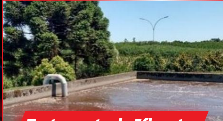
Tratamento de Efluentes
