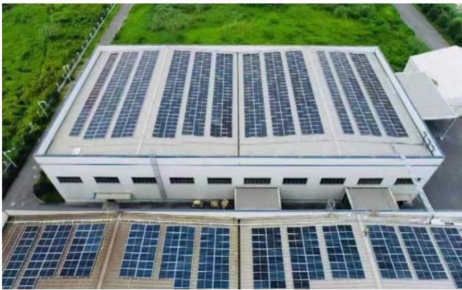
Painéis instalados na Fras-le Asia
