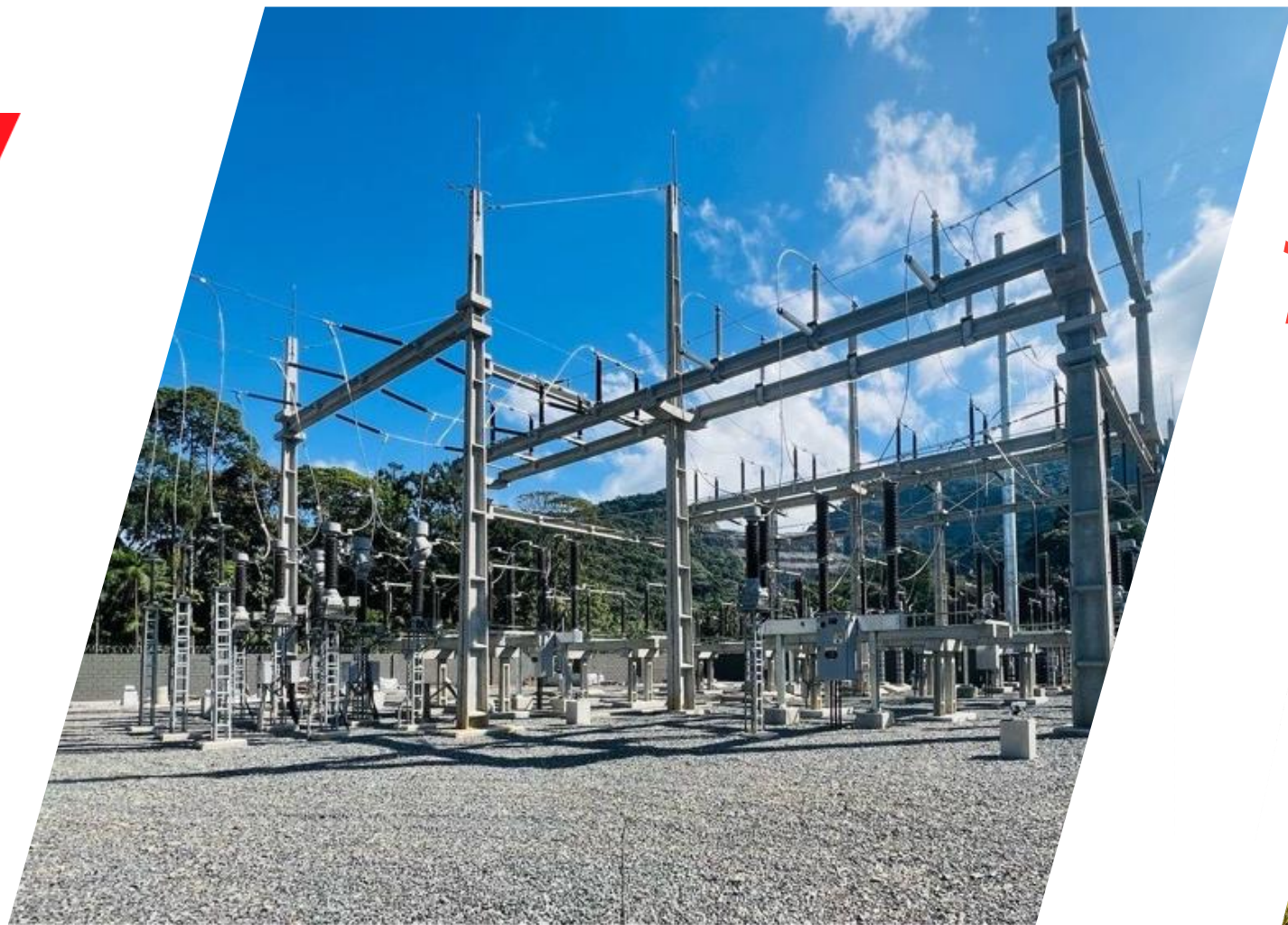
SUBESTAÇÃO DE ENERGIA FREMAX (JOINVILLE/SC)
