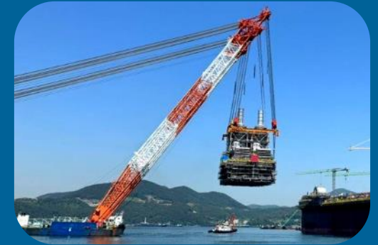
P-79 Concluídos os 5 módulos executados no Brasil. Içamento dos módulos em andamento
