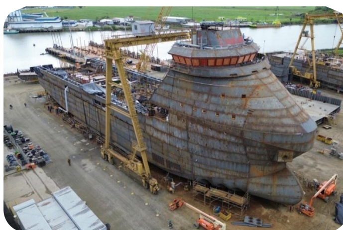
PSV 5.500, com entrega prevista para junho de 2026, em construção no estaleiro Detroit, em Itajaí/SC
