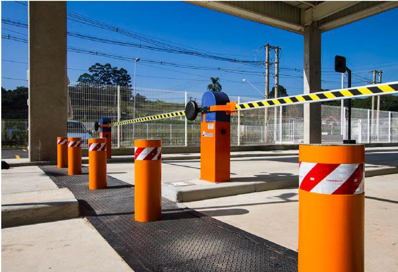
Fotos – Barreira Hidráulica e Cancela Automática
