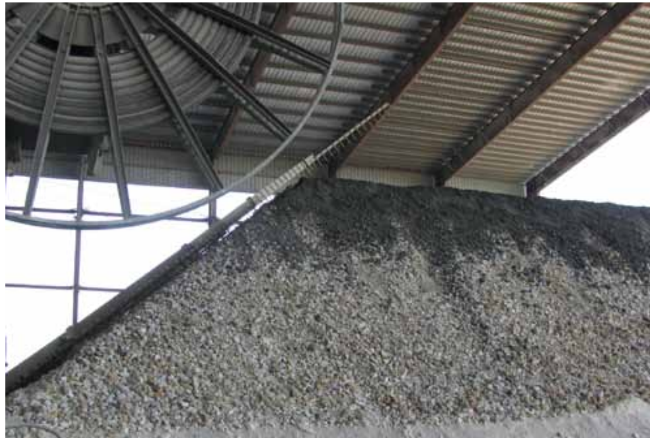
Sistema de homogeneización de materias primas alimentadas al horno de clinkerización. Planta Roberta, USA
