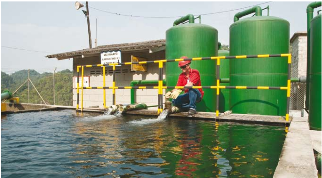
Tratamiento de agua
