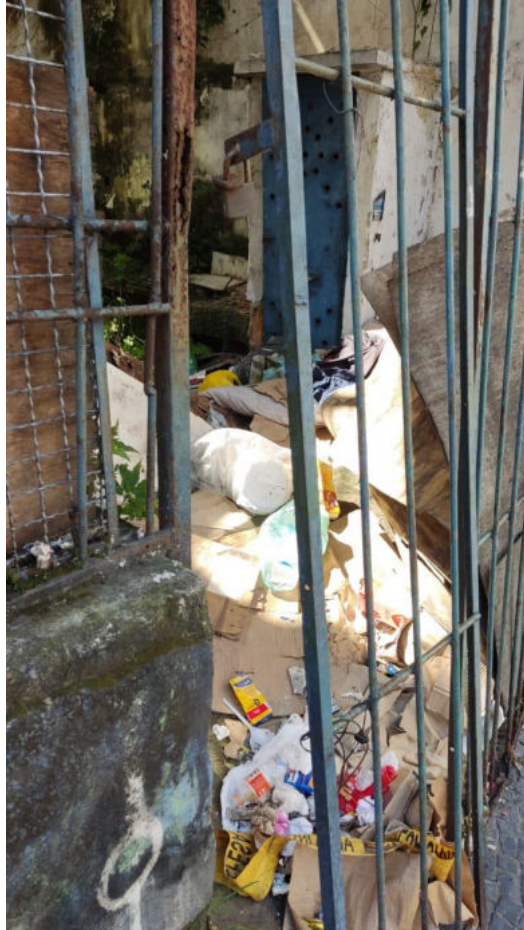
Foto 9: Obstrução do acesso ao Imóvel Avaliando
