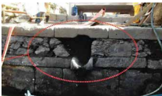
Foto 24 - Dreno bico indicado nas (lavradas) lajes do Cais da Imperatriz. Fonte: Ibid., p. 36
