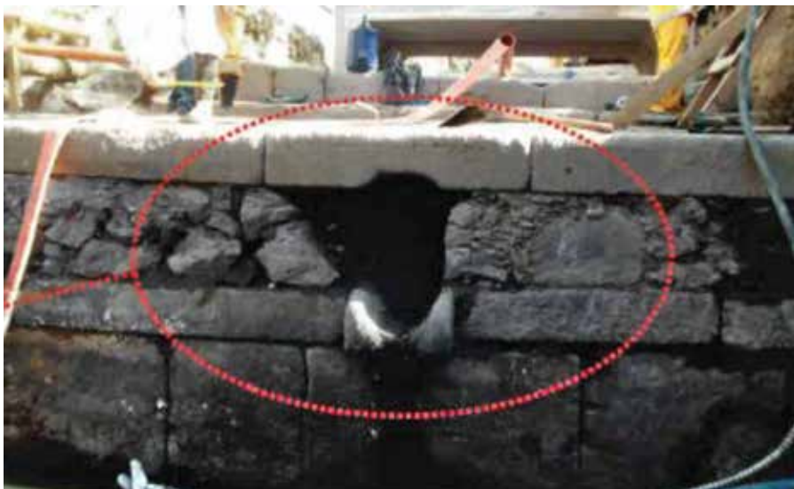
Figura 30. Local de deságue em meio às pedras costaneiras (lavradas) do Cais da Imperatriz.
