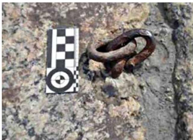
Foto 32 - Anel de amarração em metal ferroso exposto aos agentes atmosféricos anexos a borda da alvenaria. Fonte: ANDRADE LIMA, 2013
