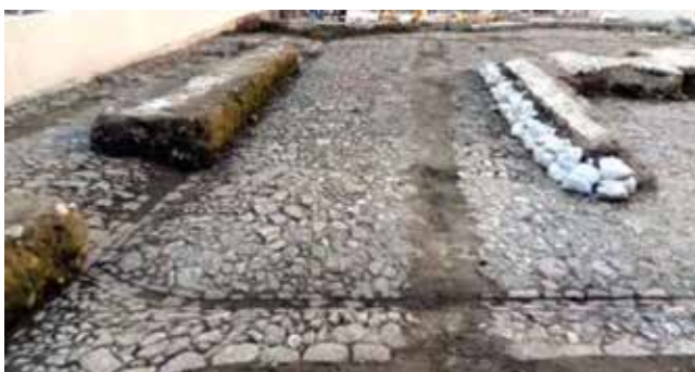
Foto 44 - Rede de drenagem de água para o Cais do Valongo. Fonte: Ibid., p.84
