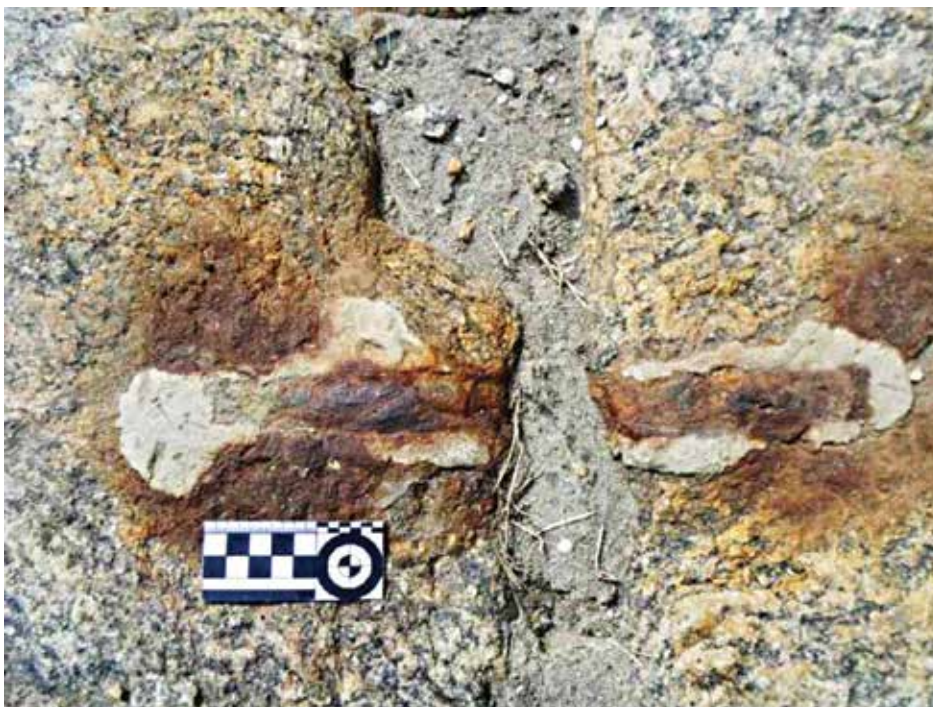
Figura 39. Marca de oxidação no entorno dos vestígios de gato metálico ferroso.
