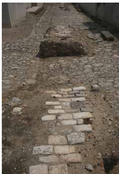
Foto 8 - Pavimentação do Cais do Valongo. Nota-se no centro da foto o alinhamento dos paralelepípedos que funcionavam como a sarjeta para a drenagem da água da chuva e, à esquerda, a borda lateral do pavimento do cais, com lajes cuidadosamente alinhadas. No centro à esquerda há blocos referentes a pavimentação do Cais da Imperatriz. Foto: João Mauricio Bragança, 2014.
