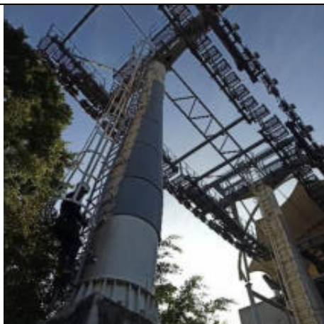
Foto 56 – Conexões do elemento de topo apresentando corrosão.
