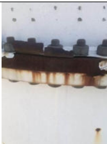
Foto 25 – Uniões entre elementos da torre com corrosão.
