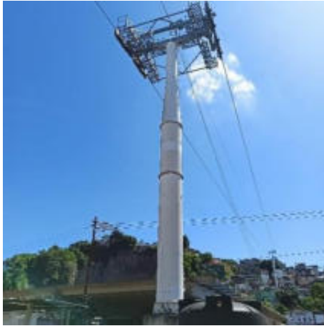
Foto 13 – Foto geral da torre 02.
