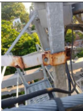
Foto 68 – Conexões do elemento de topo apresentando corrosão.
