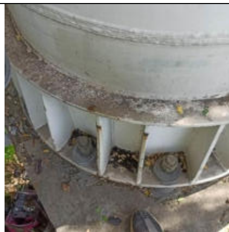
Foto 37 – Conexão da torre com base de concreto apresentando acúmulo de detritos e pontos de corrosão.
