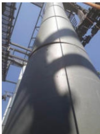
Foto 66 – Conexões do elemento de topo apresentando corrosão.
