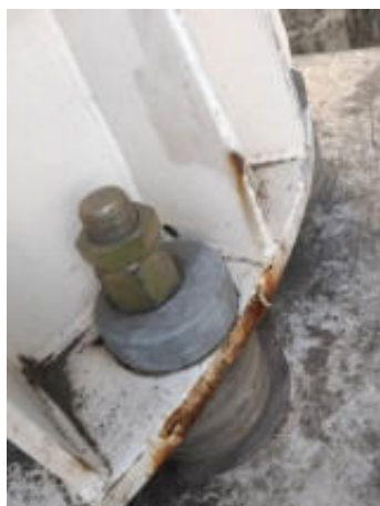
Foto 58 – Conexões do elemento de topo apresentando corrosão.
