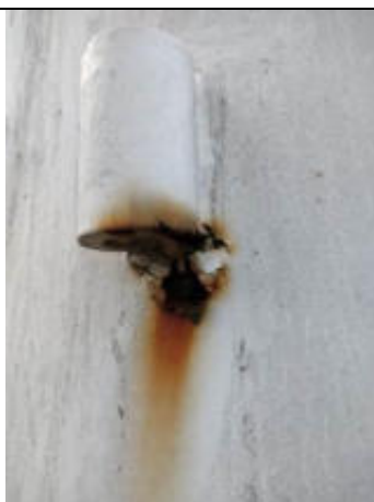
Foto 33 – União entre elemento do topo com a torre apresentando corrosão.
