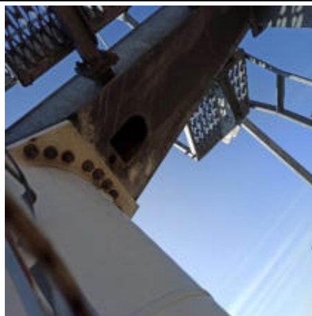
Foto 51 – União entre os elementos da torre com o de topo apresentando pequenas áreas com corrosão
