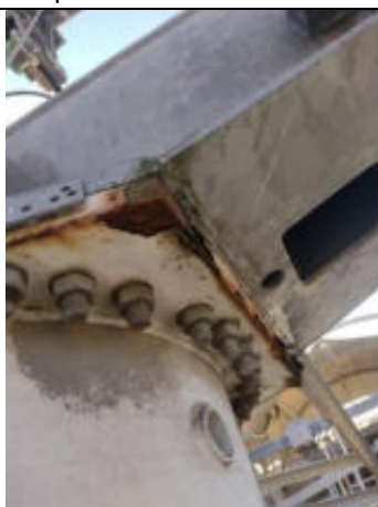
Foto 70 – Conexões do elemento de topo apresentando corrosão.
