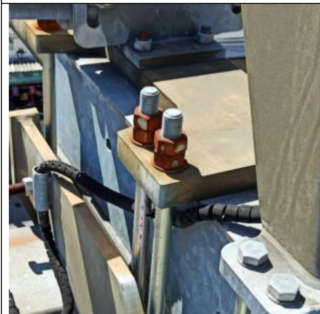
Foto 11 – Porcas das conexões da estrutura do topo apresentando corrosão mais severa.
