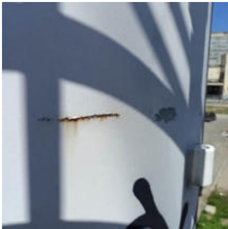
Foto 15 – Região apresentando corrosão provocada por pintura danificada.
