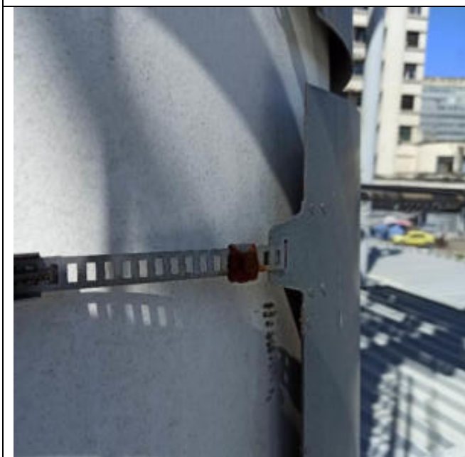
Foto 7 – Conexões das chapas metálicas de proteção apresentando corrosão mais severa.
