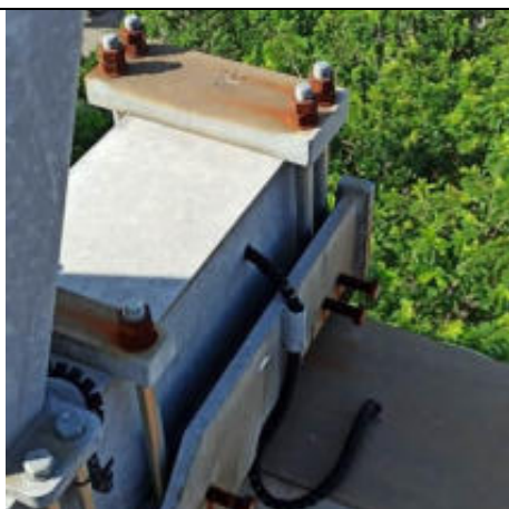
Foto 54 – Conexões do elemento de topo apresentando corrosão.
