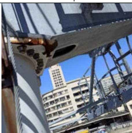
Foto 19 – União entre elemento do topo com a torre apresentando corrosão.
