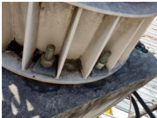
Foto 22 – Junção entre a torre e a base de concreto apresentando acúmulo de detritos e corrosão.
