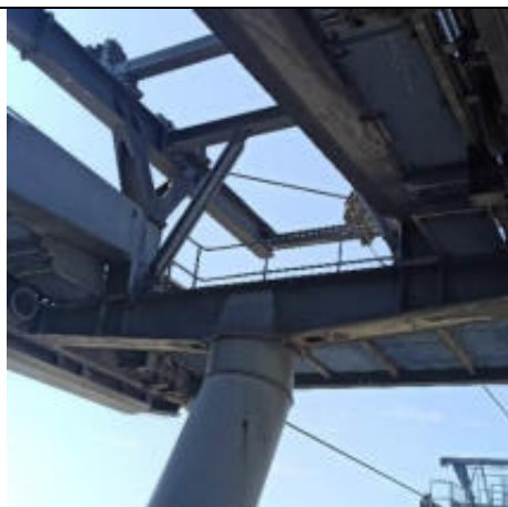
Foto 74 – Estrutura de topo apresentando corrosão nas conexões.
