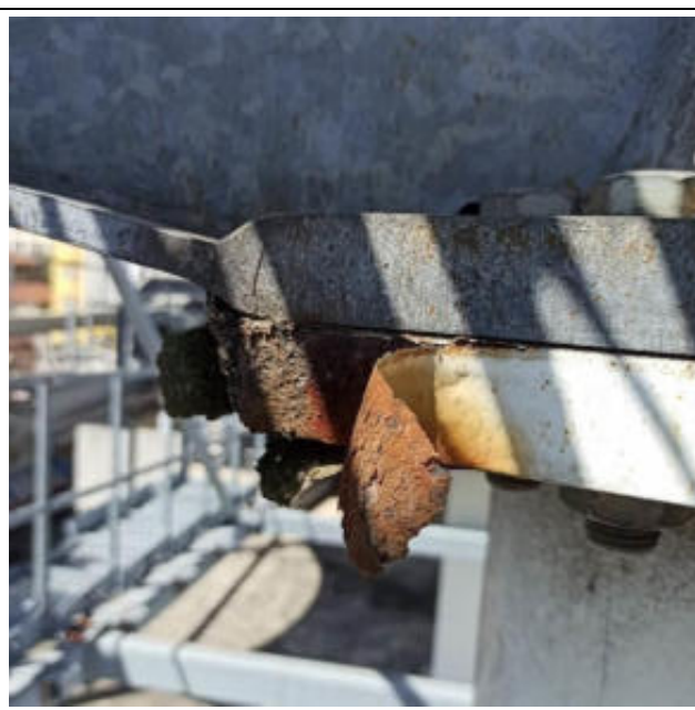
Foto 10 – Foto ampliada da região corroída.
