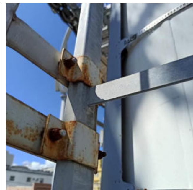
Foto 5 – Anteparo físico da escada e suas conexões com corrosão.
