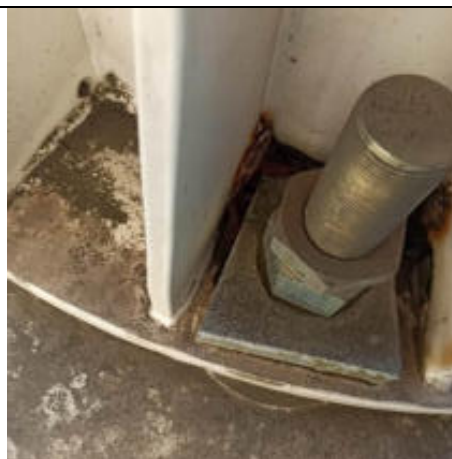
Foto 49 – Conexão entre torre e bloco de concreto apresentando pequenas regiões com corrosão.
