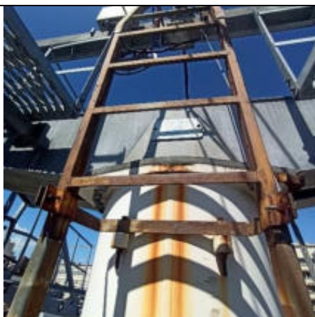
Foto 17 – Parte da escada situada no topo da torre apresentando corrosão e deterioração da pintura em toda sua superfície.
