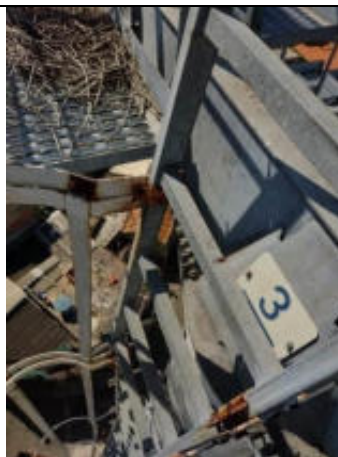
Foto 28 – Conexões dos elementos do topo da torre apresentando corrosão nas porcas.
