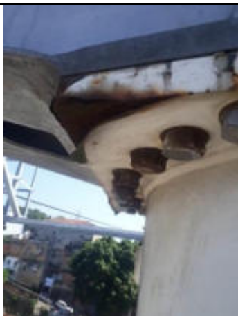
Foto 27 – União entre elemento do topo com a torre apresentando corrosão.
