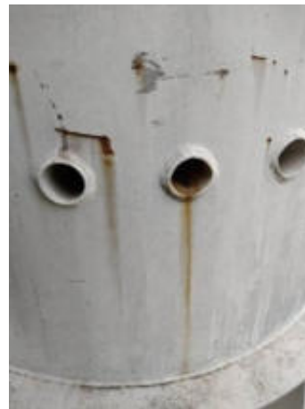
Foto 32 – Região próxima a base apresentando sinais de corrosão.
