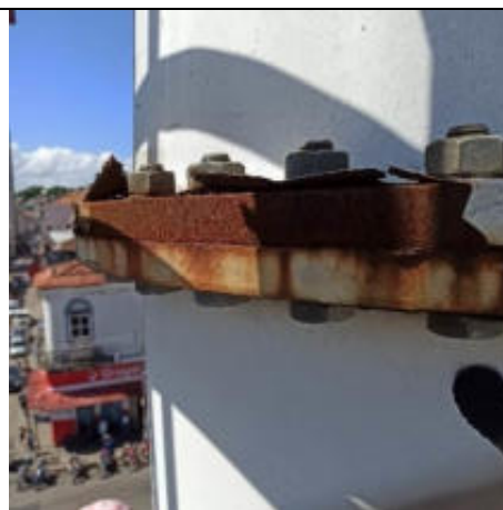
Foto 18 – Junções entre elementos metálicos com estado de corrosão mais avançado.
