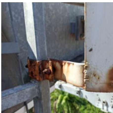
Foto 52 – corrosão das conexões do anteparo da escada.
