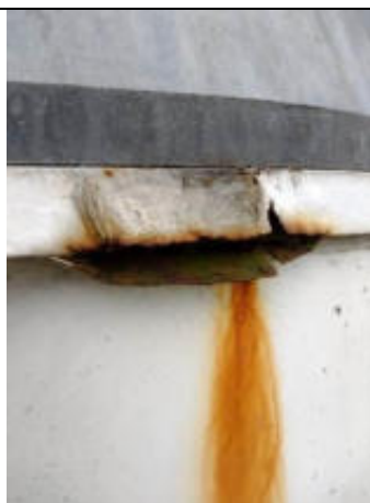
Foto 34 – Conexões dos elementos do topo da torre apresentando corrosão nas porcas.
