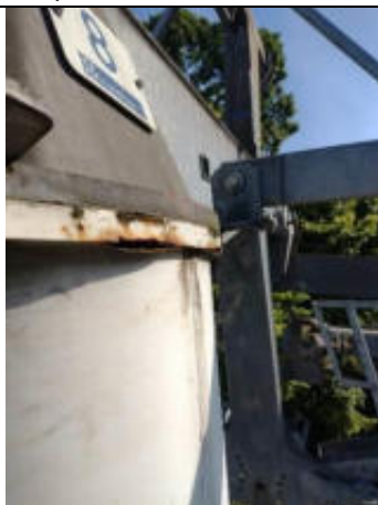
Foto 62 – Conexões do elemento de topo apresentando corrosão.
