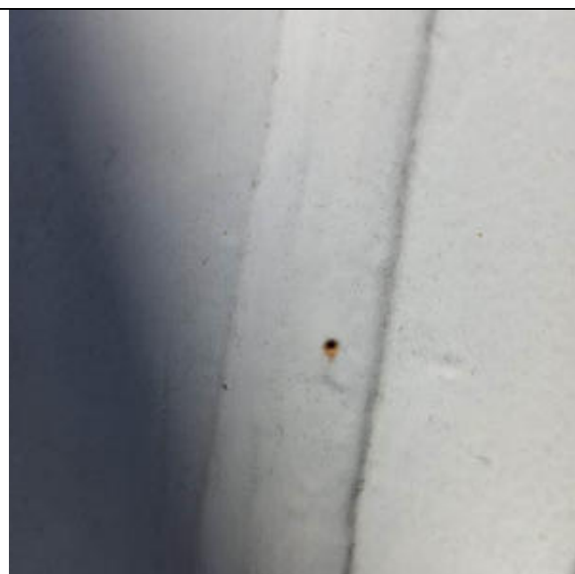
Foto 6 – Pite de corrosão na solda do elemento tubular.
