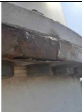
Foto 26 – Foto aproximada da corrosão nas uniões entre elementos tubulares da torre.
