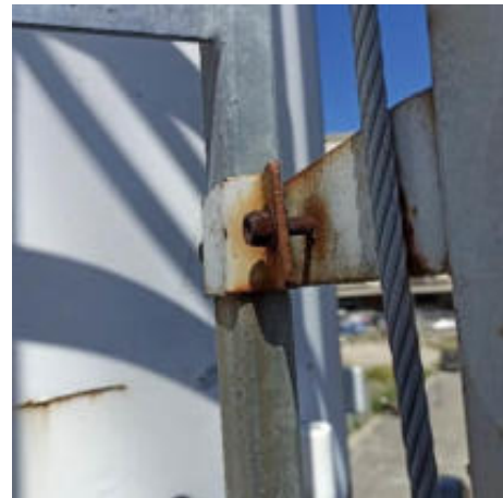
Foto 16 – Conexões da escada e seu anteparo físico apresentando diversas áreas corroídas.
