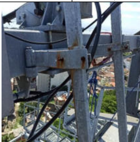
Foto 35 – Conexões dos elementos do topo da torre apresentando corrosão nas porcas.
