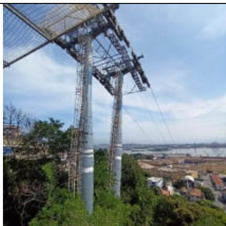
Foto 36 – Vista geral das torres 05 e 06.
