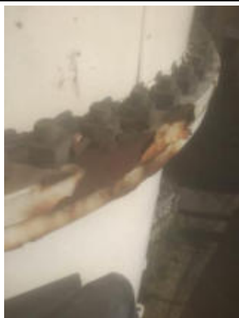
Foto 50 – União entre elementos tubulares com corrosão avançada.
