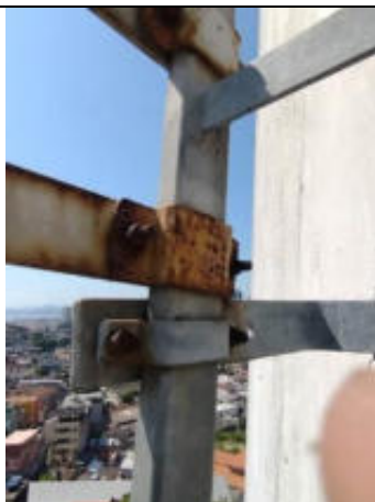
Foto 23 – Anteparo da escada e conexões apresentando corrosão.
