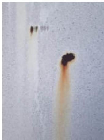
Foto 24 – Pontos de corrosão no corpo dos elementos da torre.
