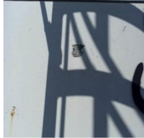
Foto 14 – Poucas regiões com pites de corrosão e pintura danificada.
