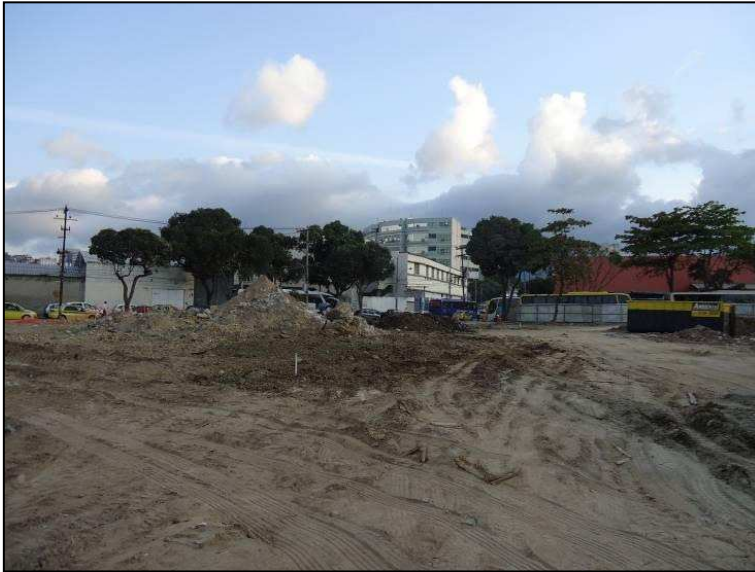
Ambiente da Área Anexa da Rua da Gamboa, onde existiam galpões, demolidos pelas obras do Porto Maravilha.
