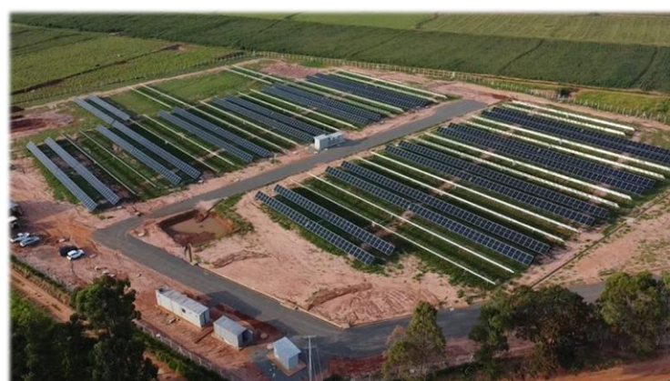
Usina fotovoltaica Alto Paraná, no PR.
