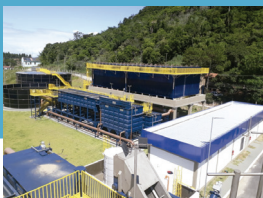
ETE Figueira, capacidade 75l/s
