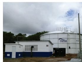
Reservatório 1.000 m 3 e Booster
