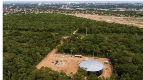
Reservatório Santa Terezinha 4.000m 3 (Cuiabá/MT)
