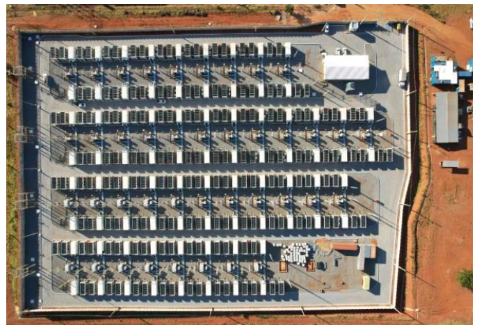
Data Center integrado ao Complexo Eólico Alto Sertão III
