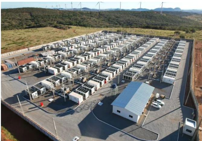
Data center integrado ao Complexo Eólico Alto Sertão III.
