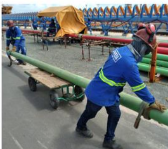
Transporte de tubos anteriormente com o carro plataforma sem a devida amarração com risco de queda do material.
