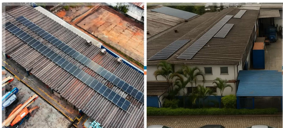
Imagens 2 e 3: Placas fotovoltaicas na matriz Lau Rent (imagem lado esquerdo) e na Central de Operação ENESA (imagem lado direito), em Arujá/SP.
