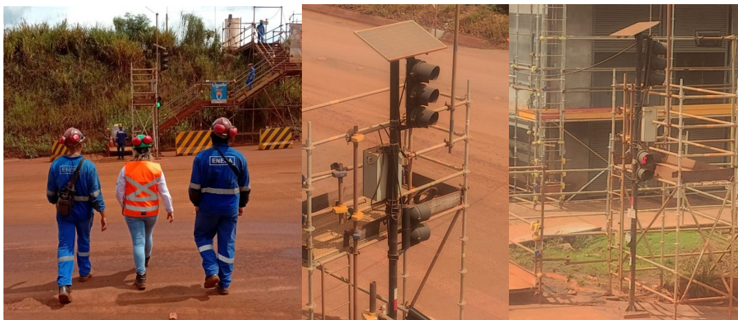
Imagens 4 e 5: Semáforos a Led com placas voltaicas na unidade da Vale S11D, em Canaã dos Carajás/PA.
