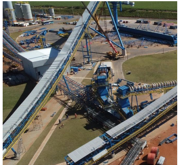
Bracell Pátio de Madeiras - 110 CC
