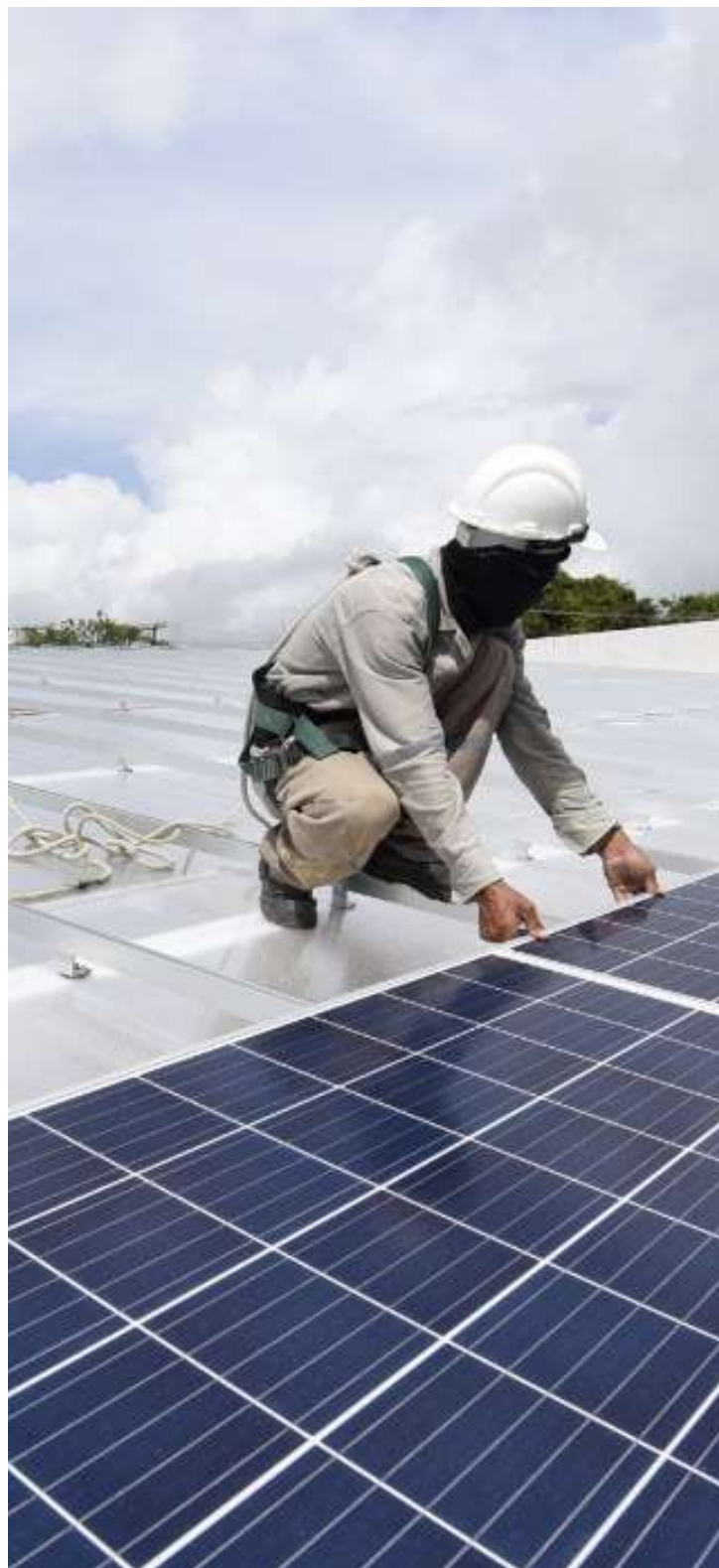
Planta Solar Fotovoltaica Estacionamento Cagece
