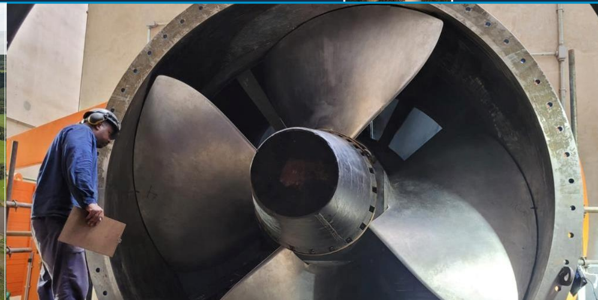
PCH Foz do Cedro – Turbinas 12,35 MW
