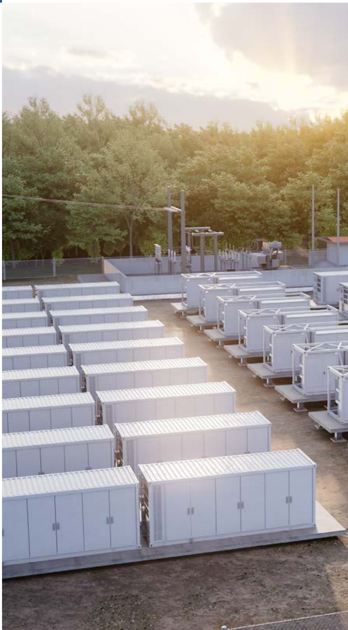
Sistema de Armazenamento de Energia em Baterias (BESS)
