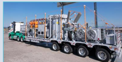
Subestação Móvel Digital
