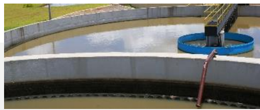
Estação de Tratamento de Efluentes
