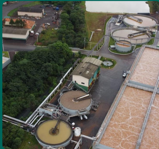
MDL ESTAÇÃO DE TRATAMENTO DE EFLUENTES
