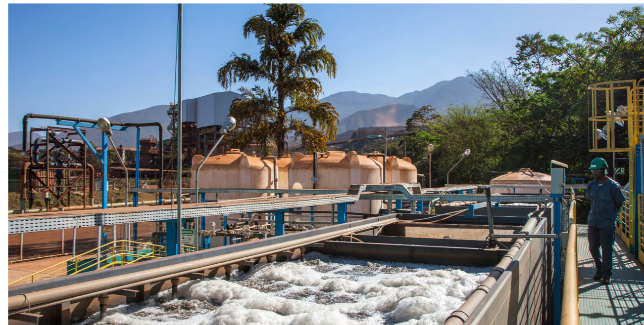
Estação de tratamento de efluentes da Mina Alegria – Minas Gerais, Brasil. Foto: Ricardo Teles
