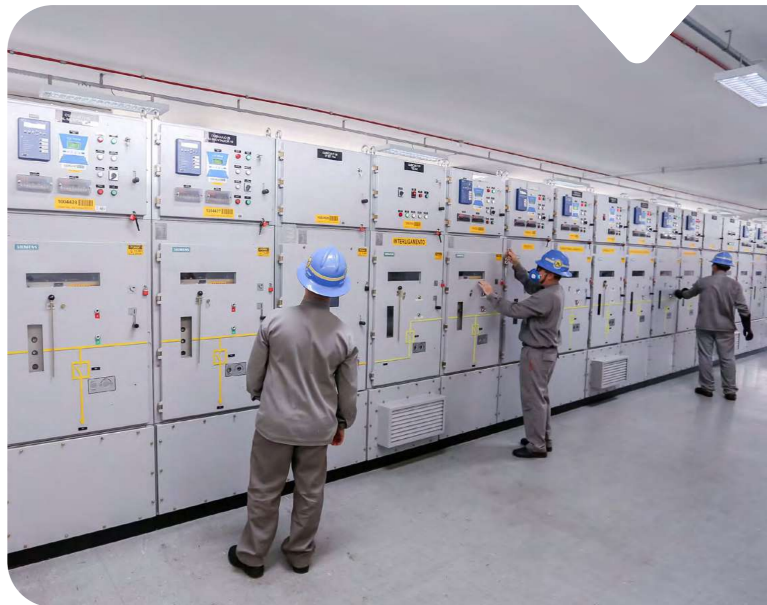
Integrantes do Grupo de Conservação de Energia na subestação de energia elétrica da Tupy
