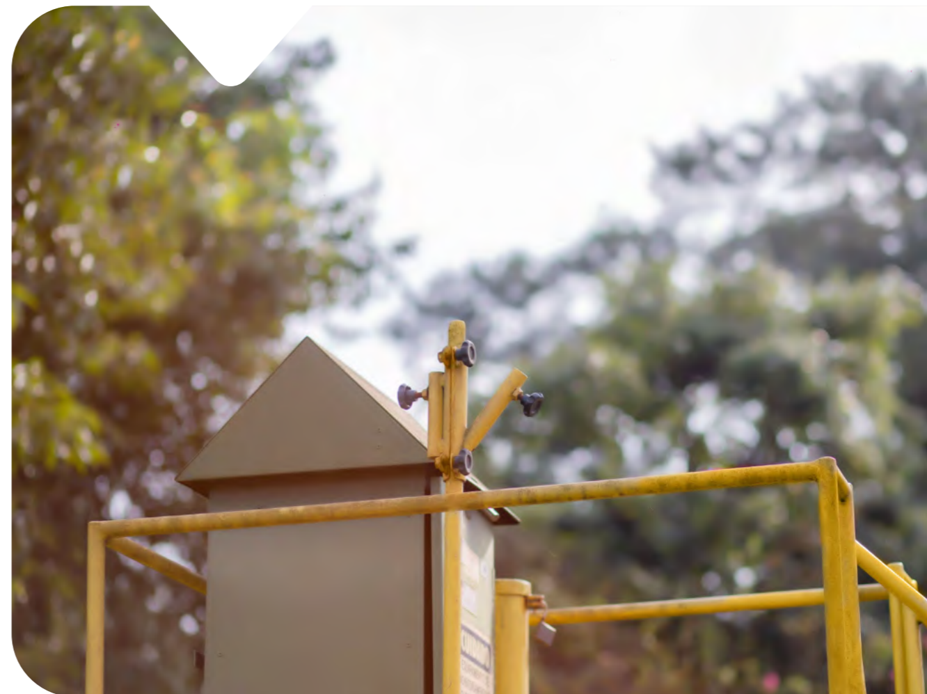
Equipamento de monitoramento contínuo da qualidade do ar
