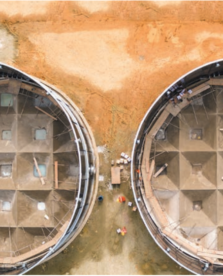
Estação de Tratamento de Esgoto CIC Xisto
