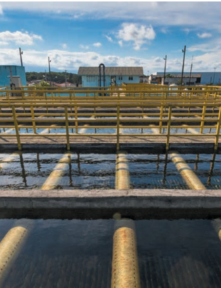
Estação de Tratamento de Água - Praia de Leste
