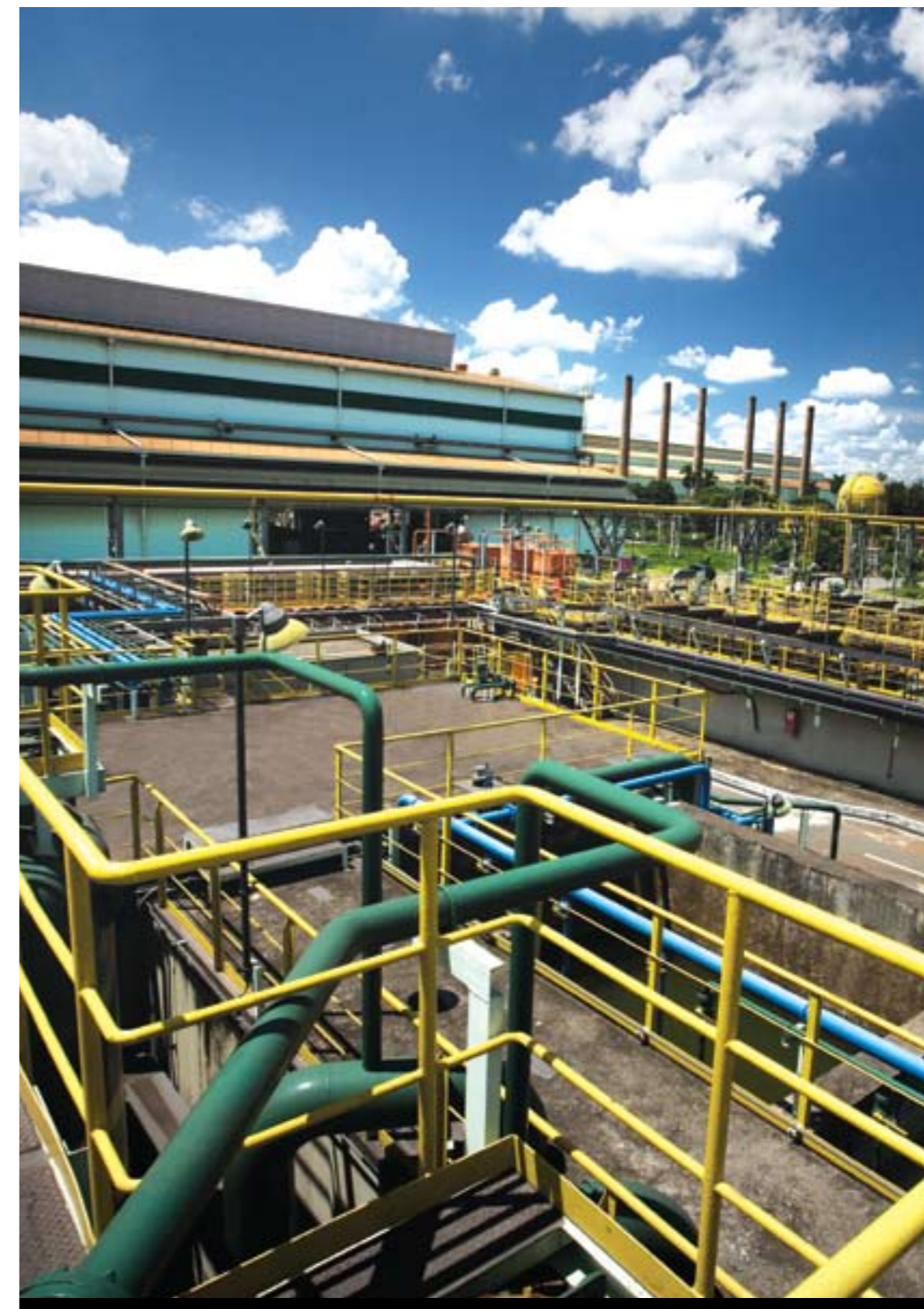
Estação de Tratamento de Efluentes (ETE) da Unigal.
