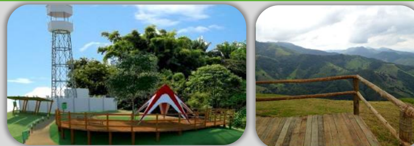
Construção da rampa de voo livre na comunidade de Achado, 2ª maior do Estado de Minas Gerais
