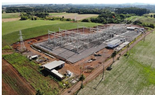
Imagem Subestação Lajeado 3
