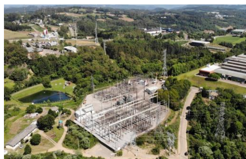
Imagem Subestação Garibaldi
