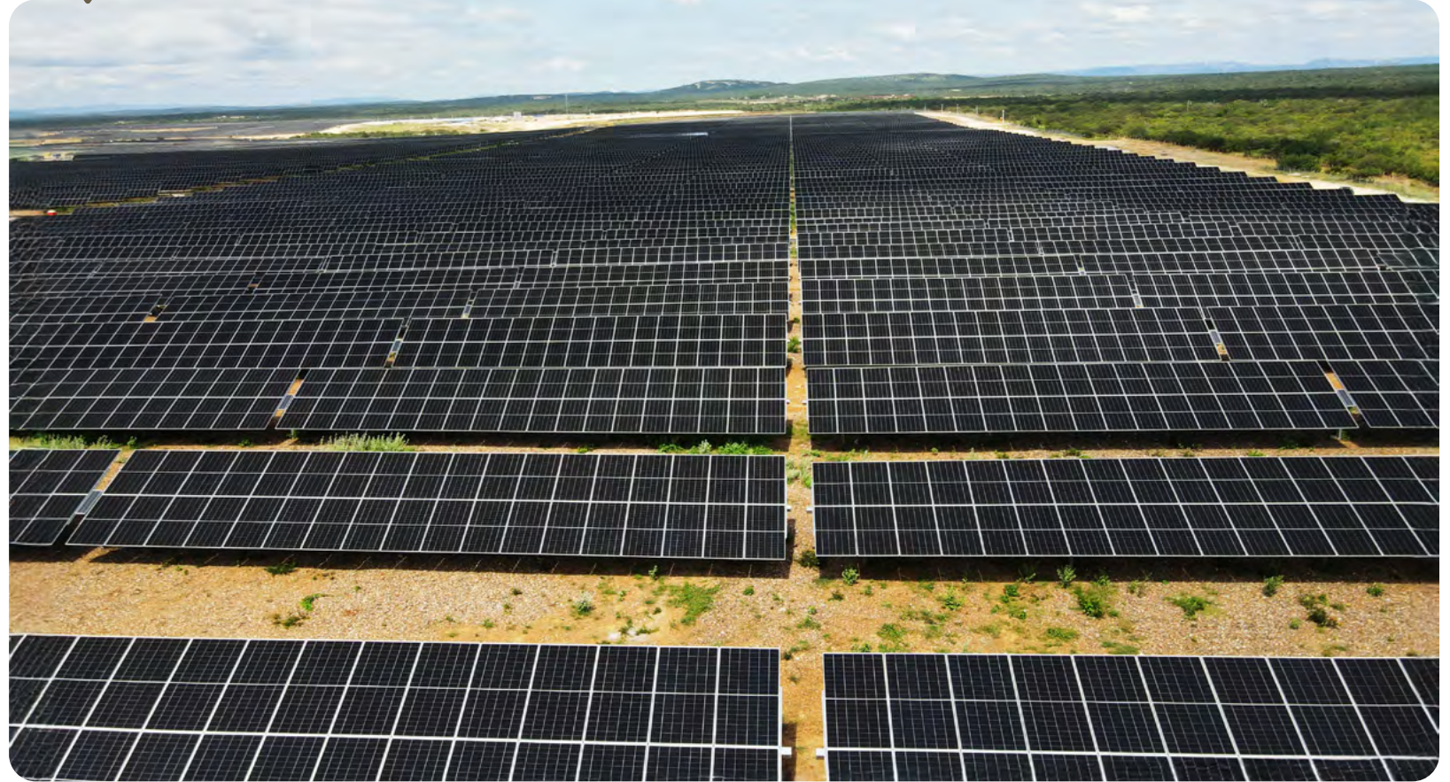
Futura I Solar Farm
