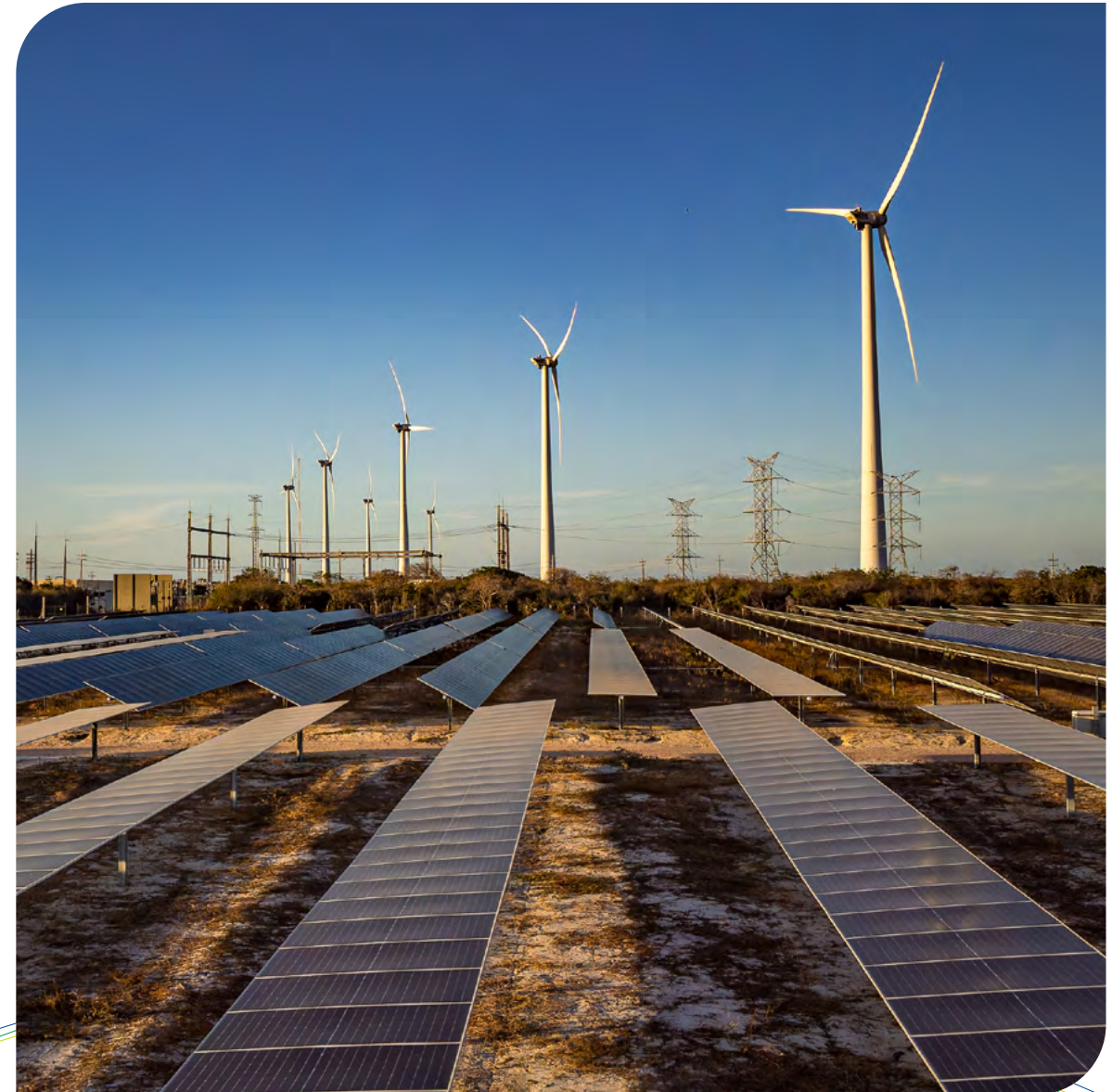
Pitombeira PPP and Energia dos Ventos Wind Farm (Ceará)
