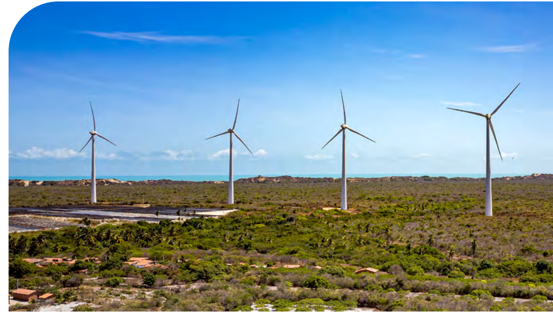
Pitombeira PPP and Energia dos Ventos Wind Farm (Ceará)
