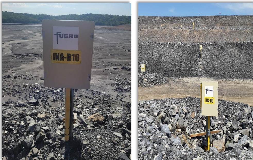
Figura 38: Indicador de nível d'água automático instalado no corpo da barragem
