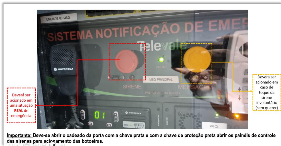
Figura 6: Acionamento manual - via botoeiras na sala de comando
