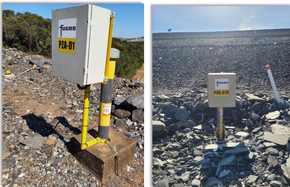
Figura 39: Piezômetro automático instalado no corpo da barragem
