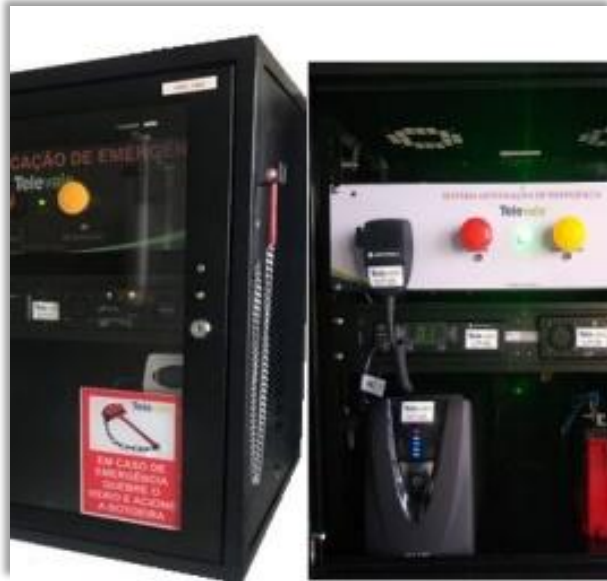
Figura 5: Central de Operação Local Externa (COL) e Central de Operação Local Externa Redundante (COL-R)
