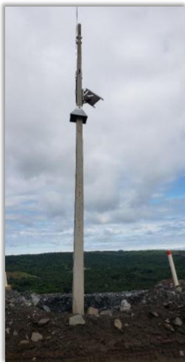
Figura 36: Torre de transmissão do sinal dos instrumentos automatizados
