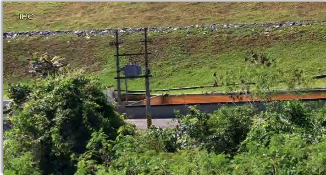
Figura 34: Câmera instalada no corpo da barragem para verificação da estrutura a jusante e da fundação da barragem
