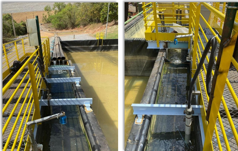
Figura 40: Medidor automático de vazão de dreno da barragem instalado
