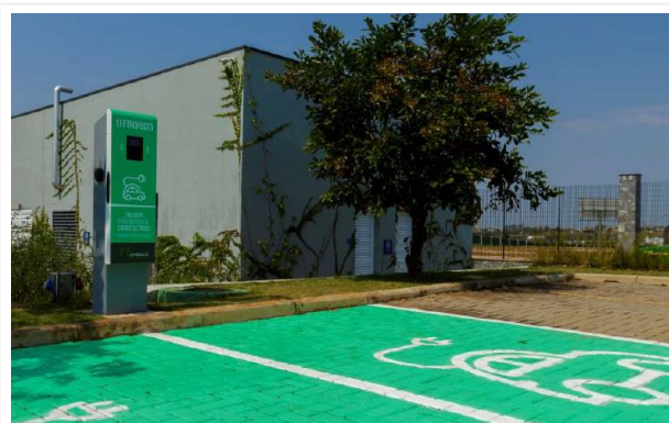
Agibank Campus: pontos para abastecimento de veículos elétricos.
