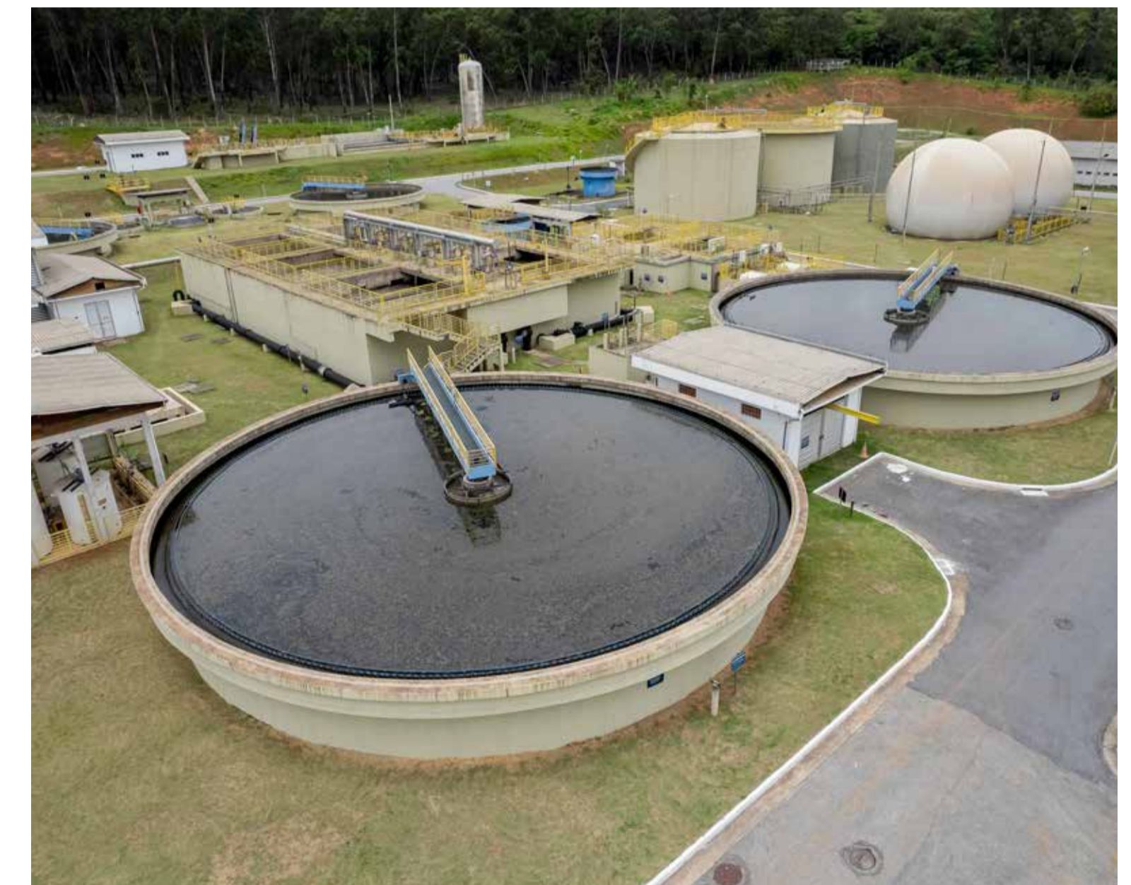
Copasa, Ibirité WWTP
