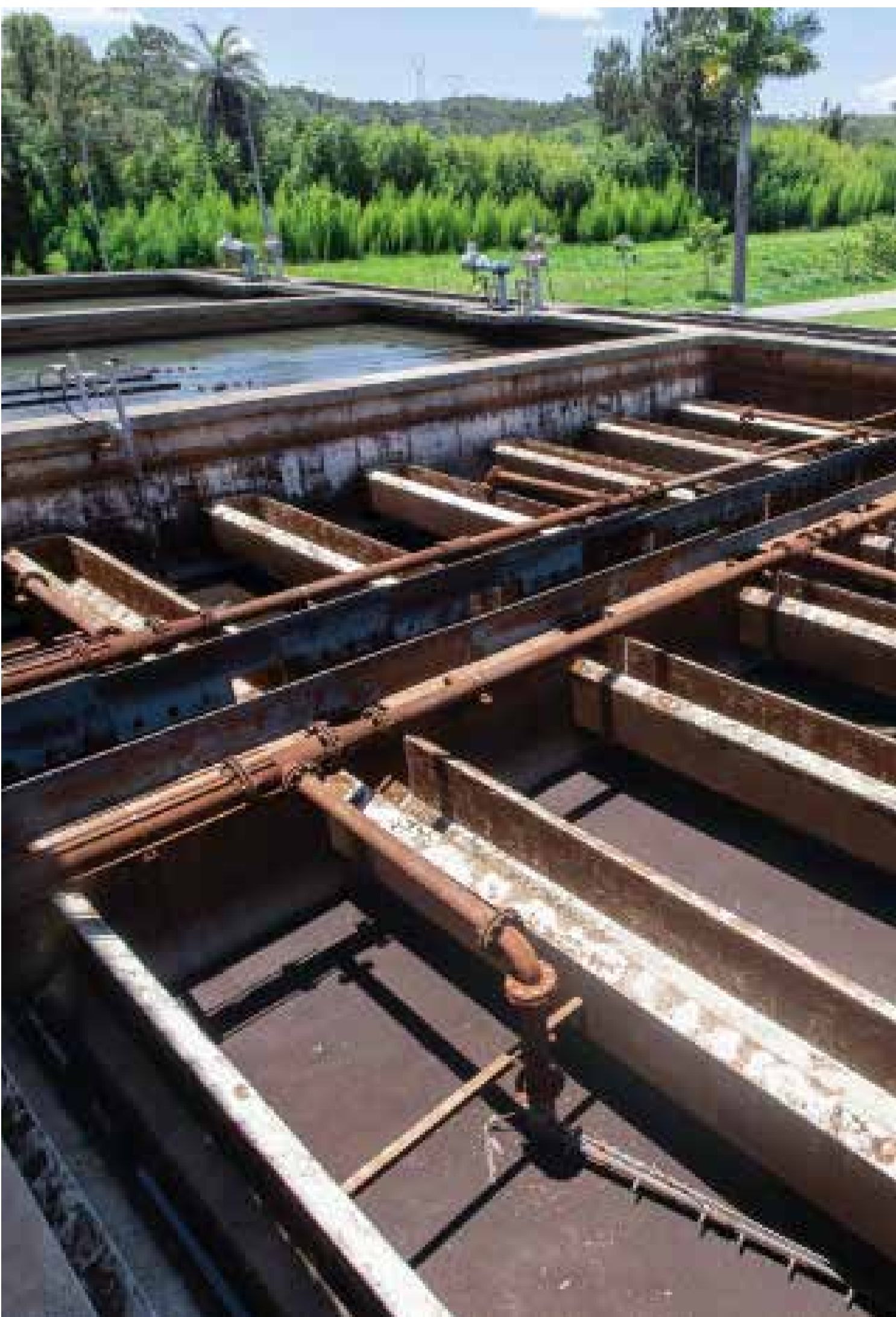
Copasa, Rio das Velhas WTP
