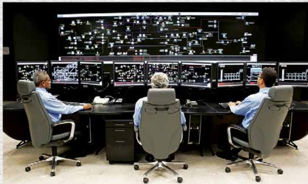
Centro de Operações de Sistema - COS Belo Horizonte
