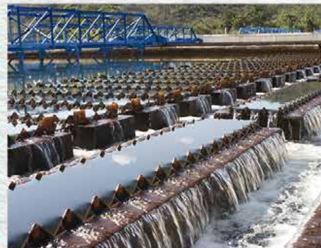
ETA Rio das Velhas - Nova Lima
