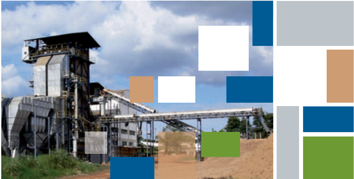
Cogeneración de energía con utilización de biomasa
