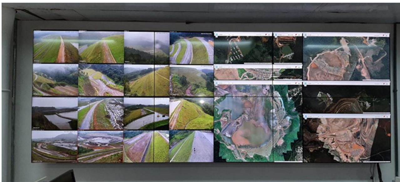
Figura 5-1 - Vista do Vídeo Wall da Sala de Monitoramento de Barragens
