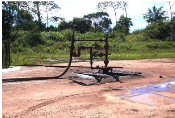
Poço equipado com Bomba Eletro Submersível
