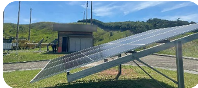
SDV 11 do GASDUC III (RJ): 2 painéis de 470Wp / Geração de energia em 2024 (214 dias): 184kwh
