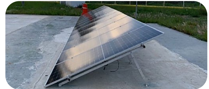
PE Pindamonhangaba II (SP) 15 painéis de 550Wp / Geração de energia em 2024: em fase de comissionamento
