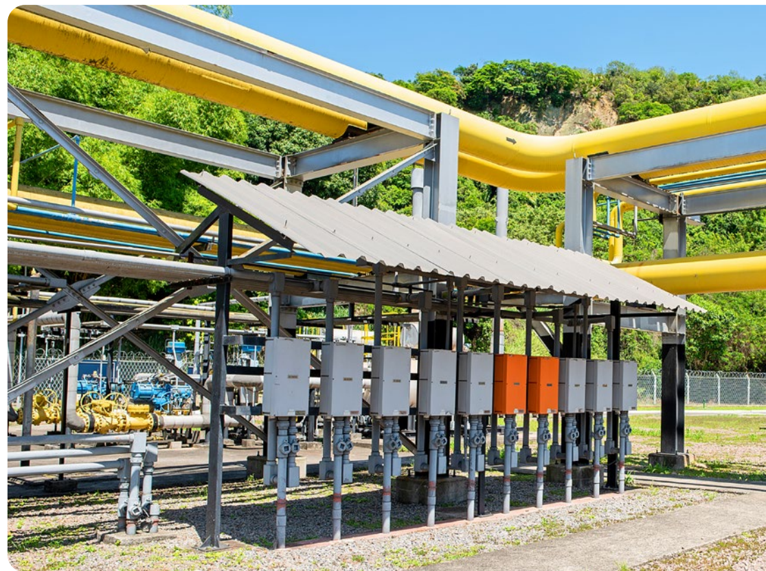
Caixas de Interligação Elétrica na ECOMP Campos Eliseos
