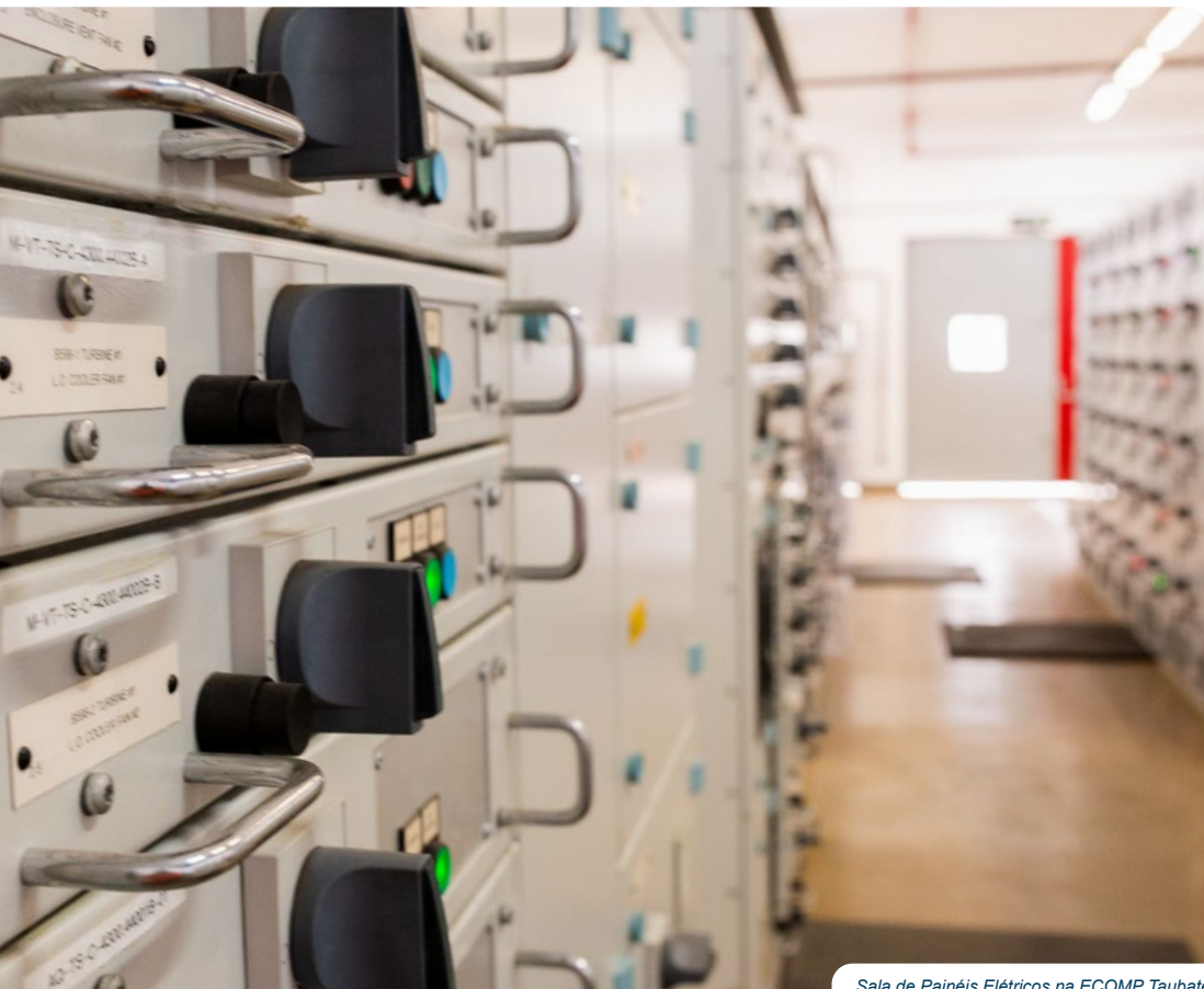
Sala de Painéis Elétricos na ECOMP Taubaté
