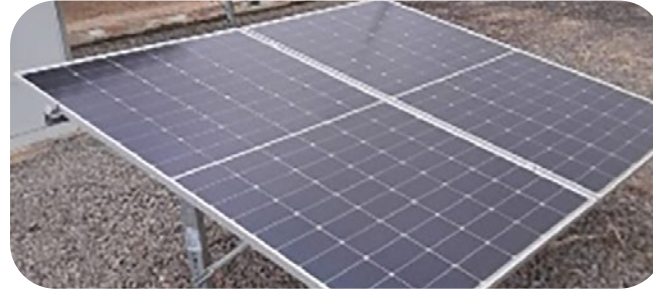
SDV 18 do GASCAR (SP): 6 painéis de 550Wp Geração de energia em 2024: 5,04MWh
