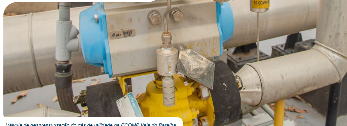
Válvula de despressurização do gás de utilidade na ECOMP Vale do Paraíba
