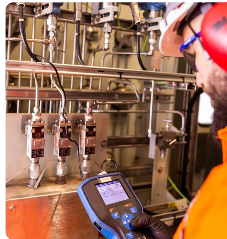
Calibração de instrumento no compressor de gás da ECOMP Taubaté
