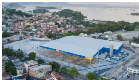
São Gonçalo (RJ) – 22/dez
